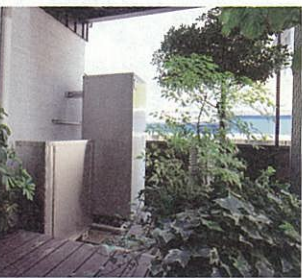
藤島建設が開発した 地中熱を利用したヒートポンプ(前)と 給湯タンク(後)。冷暖房から、 給湯、床暖房まで地中熱を使う
